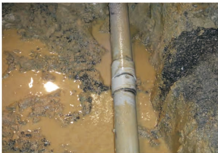
(破断した水道管)
