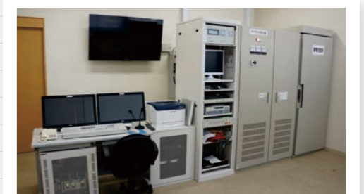
行政防災無線の通信室
