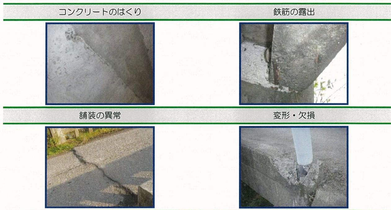
図 4 橋梁の主な損傷例
